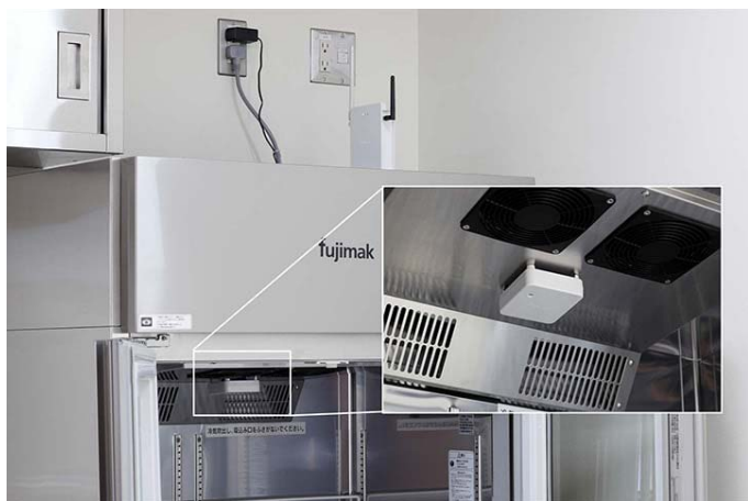
SHIMA 安裝的冷凍冷藏庫的廚房連結雲端的感測器 (框內照片) 與通信主機 (冷藏庫上方)
