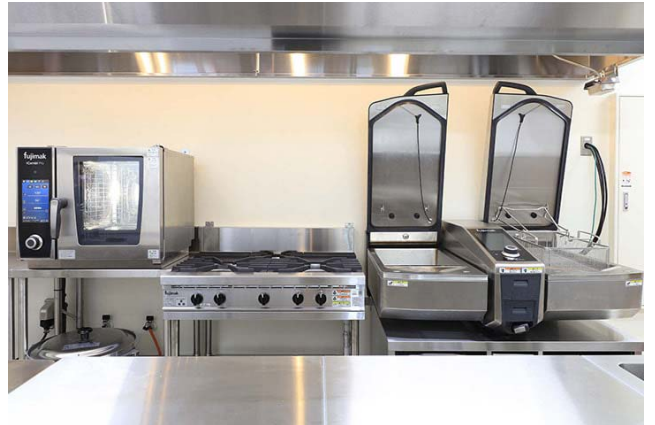
一樓的主廚房。安裝有多功能烹調系列（雙槽型）、萬能蒸烤箱、瓦斯爐等
