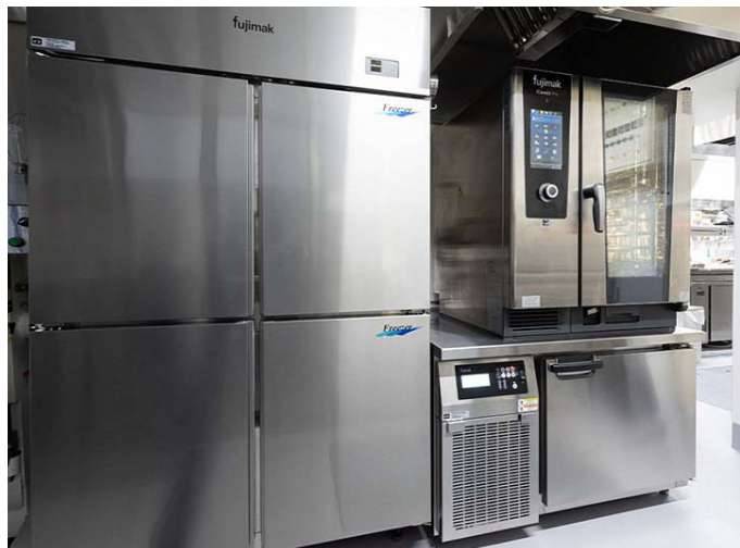
在萬能蒸烤箱的下方安裝有急速冷卻設備。「從烤箱中取出料理，可直接進行急速冷卻」（高山主廚）
