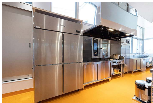
冰箱、万能蒸烤箱等所有厨房设备均使用福喜玛克产品。
